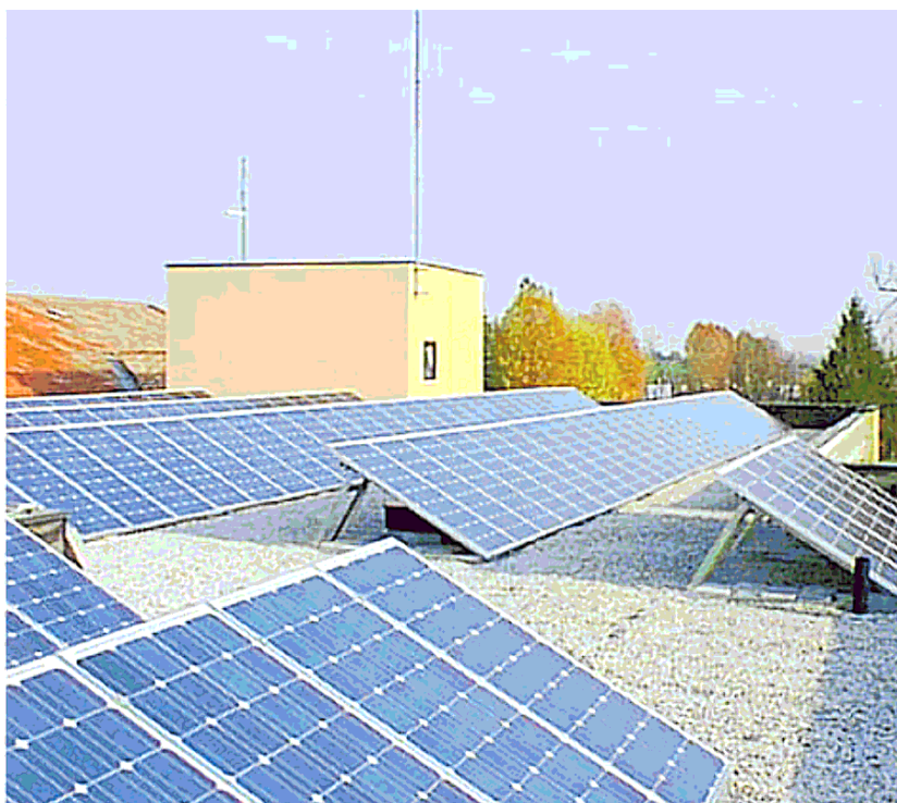
Impianti fotovoltaici sui tetti, uno dei capitoli del bando regionale
