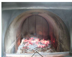
Focolare della caldaia
